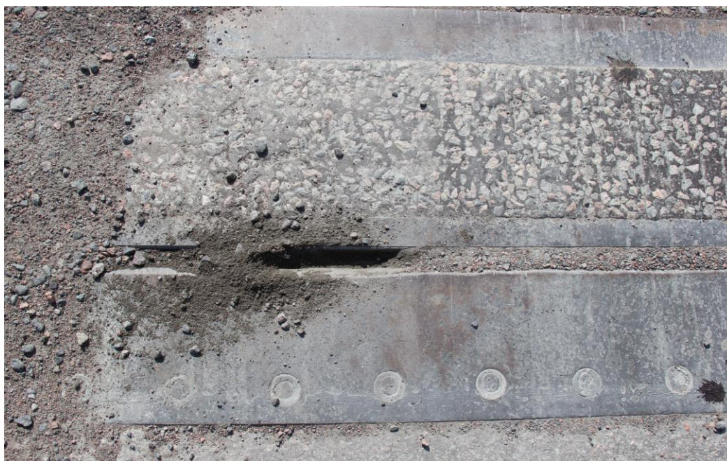
Figur 9. Spalt i rörelsefog mellan brobana och landfäste fylld med grus/sand, bör rensas.
