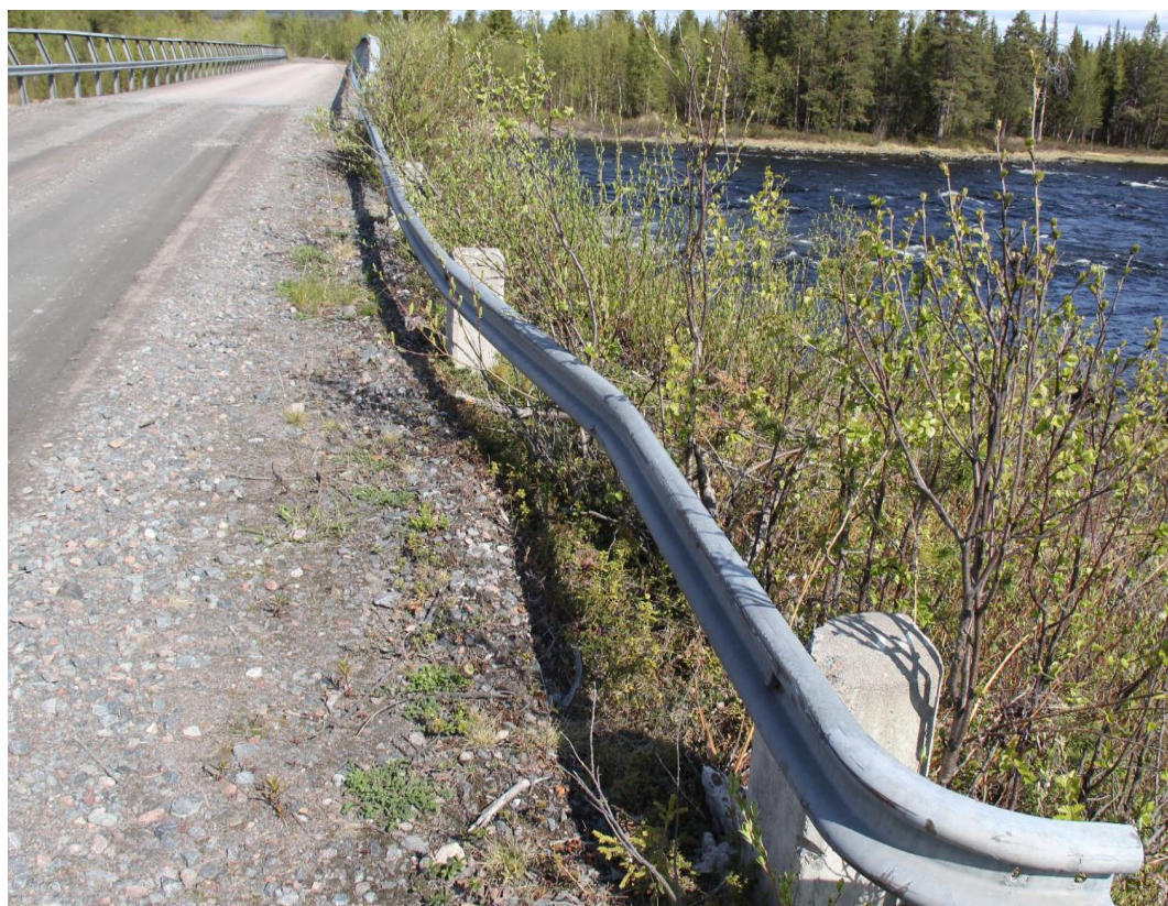
Figur 4. Påkörningsskada på räckesavslutning, sydöstra sidan.
