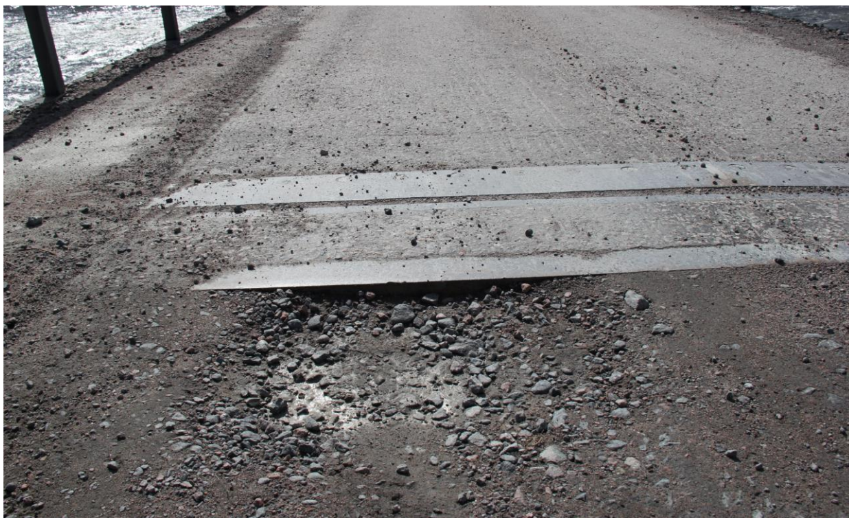
Figur 10. Försänkning/grop i vägbank vid övergång till frontmur i landfäste, norra broändan, bör fyllas ut
