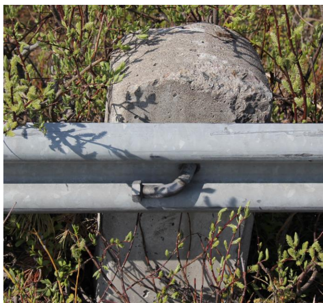
Figur 6. Skadad infästning för räckesavslutning, sydvästra sidan.
