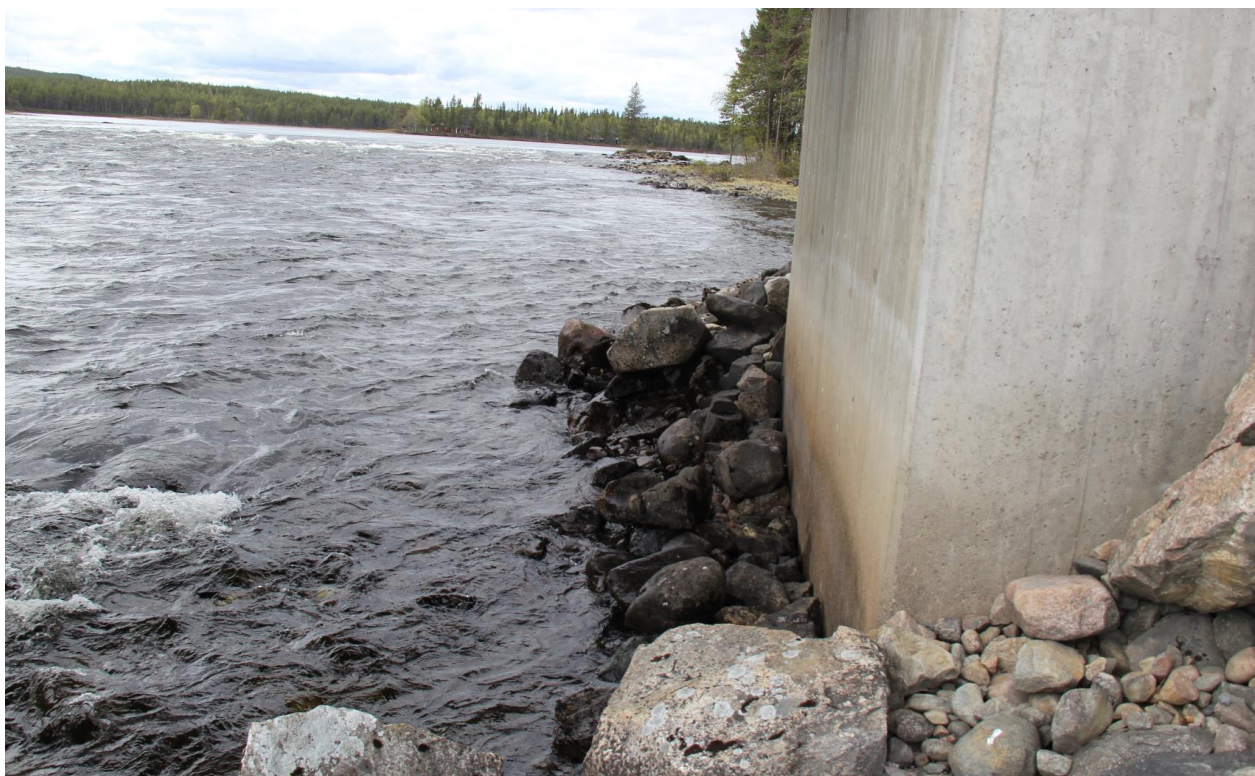
Figur 17. Norrra landfästet, erosionsskydd framför frontmur.
