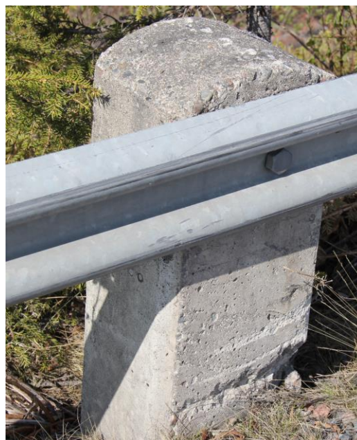
Figur 7. Sannolik plogskada på fundament för räckesavslutning, sydvästra sidan.
