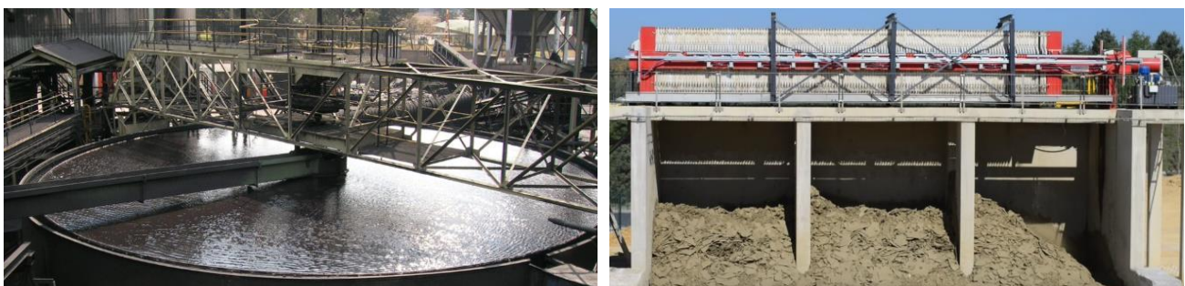
Figur 28: Exempel på utrustning för förtjockning och filtrering.
